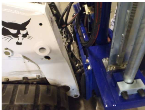
ボブキャットへの接続部
